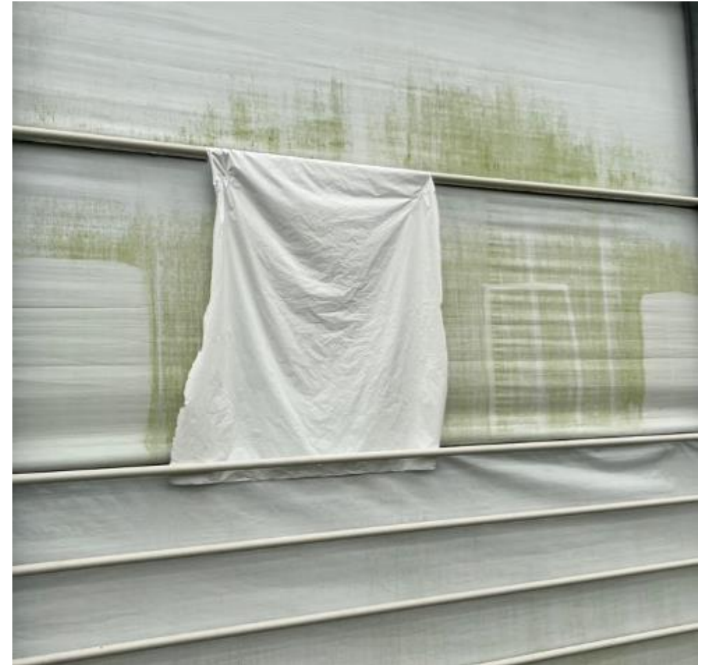
Inloopfolie / tuinplastic (vermoedelijk schadelijk (en verboden PVC).
